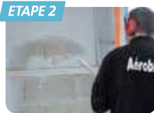
ETAPE 2 1 re passe : Projection de 3 mm d'épaisseur environ par pan de mur. Laisser 15 à 20 minutes avant la 2 e passe.
